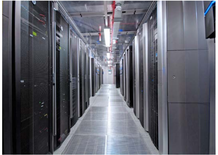
Des centres d'hébergement ultramodernes de CDK soutiennent le service numérique pour les garages.
