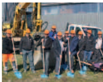
Début des travaux pour le nouveau centre de véhicules utilitaires Ford à Worben
